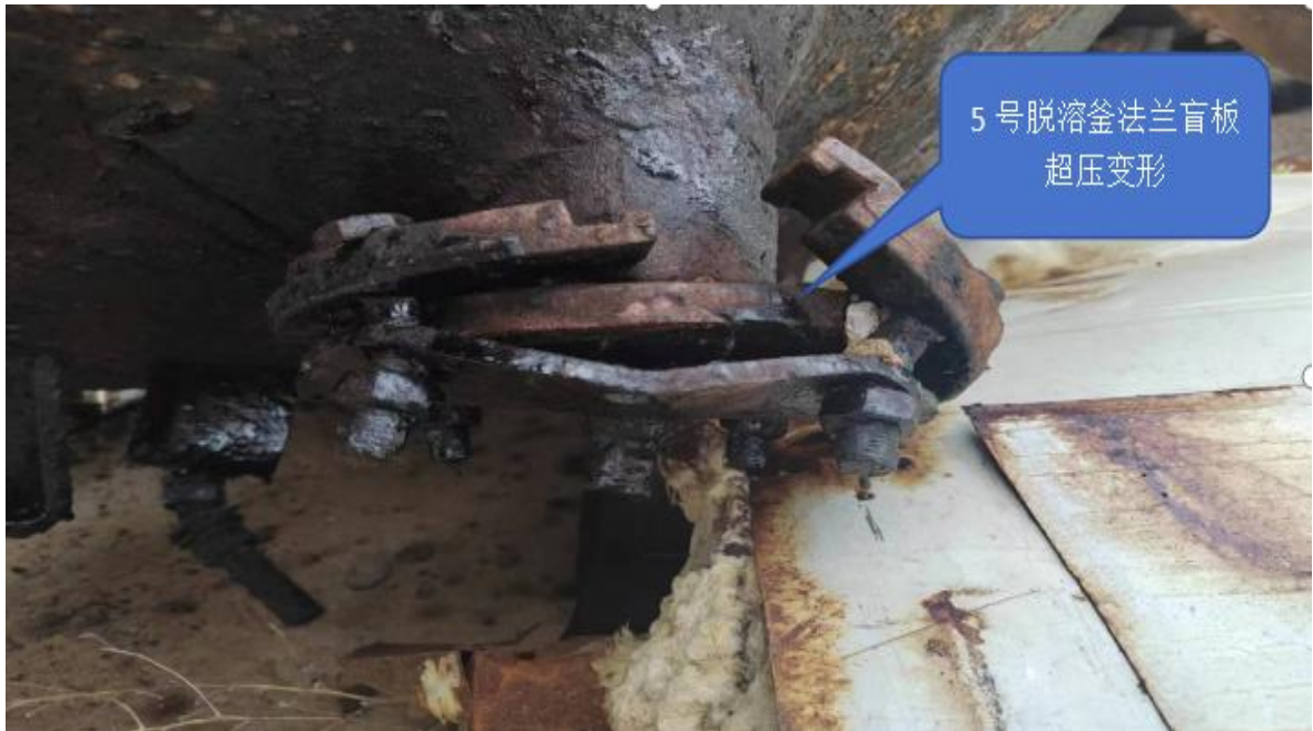
5号釜事故后法兰超压变形
