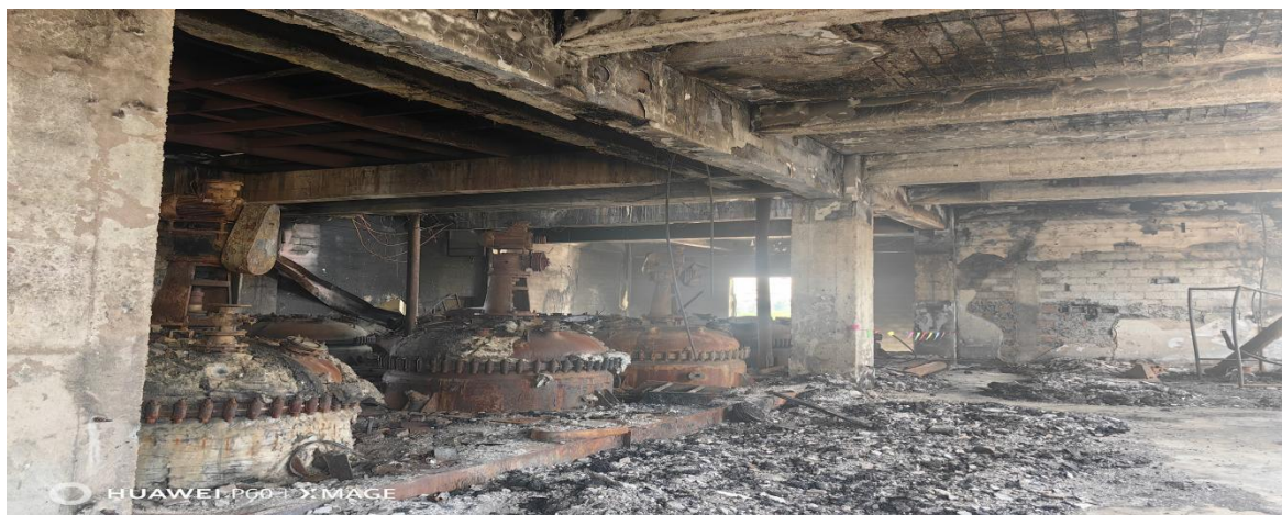
事故现场图（内部）
