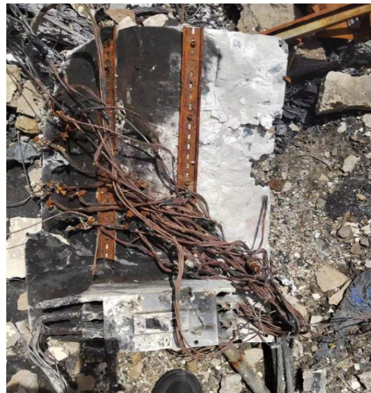
防爆电箱烧毁现场
