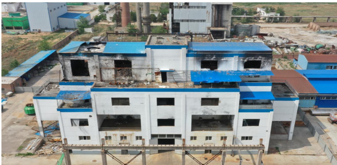
事故现场图（外部）
