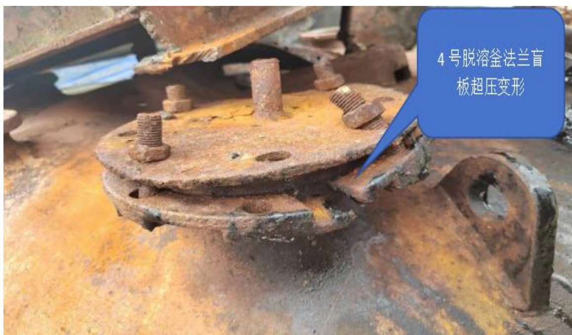
4号釜事故后法兰超压变形
