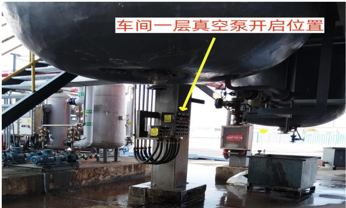
脱水车间一层真空泵操作器
