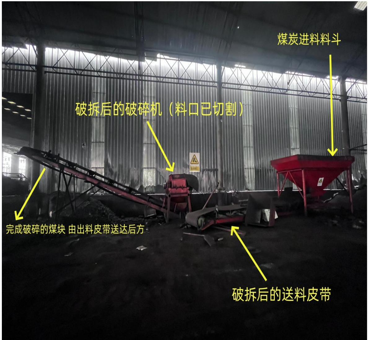
事故现场煤炭破碎机械（事故设备破拆后）
